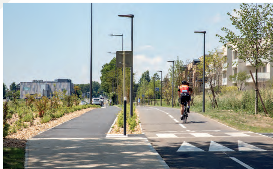
| Le long de la route de Meyrin, une voie sécurisée a été créée pour les modes de déplacement doux.
